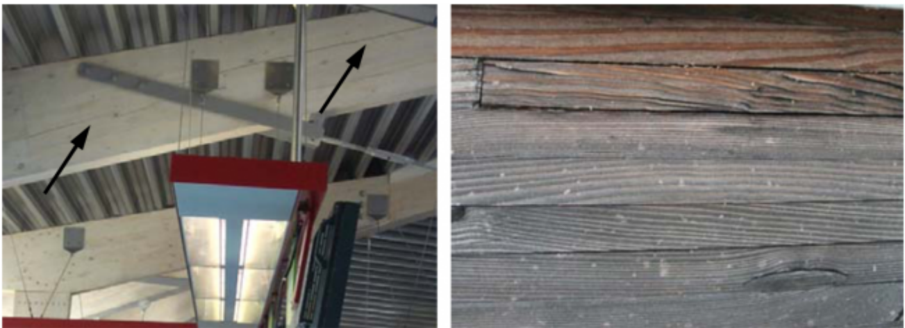
Abb. 6: Schwindrisse in Brettschichtholz-Rahmen; Rissbildung in der Klebefuge (Delaminierung)
