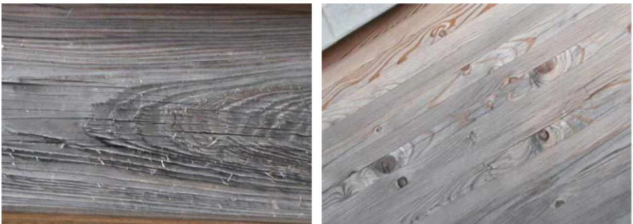
Abb. 5: Risse und Absplitterungen sowie Auswaschungen und Verfärbungen einer BSH-Oberfläche
